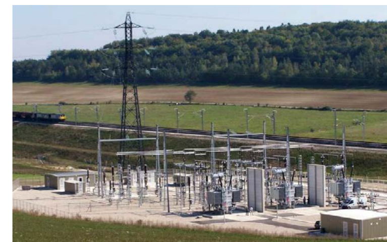
Sous-station de LGV (source : RFF)
