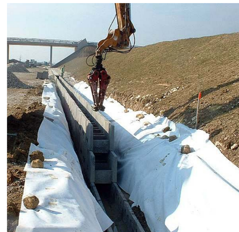
Drainage longitudinal en pied de déblai : fossé béton préfabriqué à barbacanes (source : Inexia)
