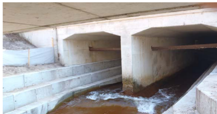
Ouvrage hydraulique avec banquettes latérales pour le passage de la faune (source : A63, Egis)
