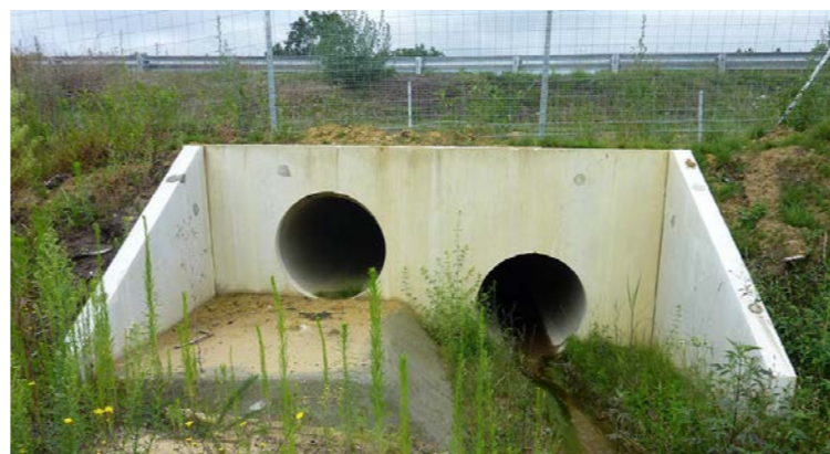
Buse hydraulique et buse sèche pour le passage de la petite faune (Source : Egis)
